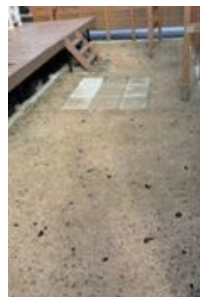
写真1 焼失範囲北側の焼け止まり
