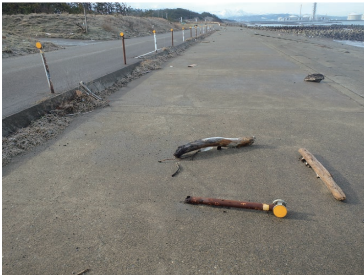
写真3 大潟漁協背後の道路面の状況(写真手前が大潟漁港)
