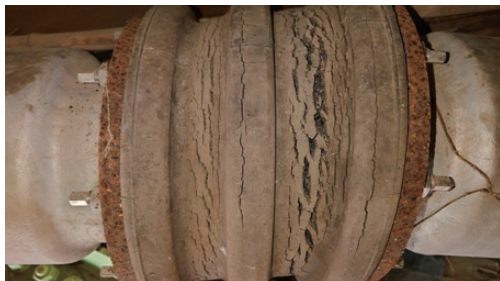
(c) ゴム型継手のひび割れ
