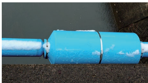
(b) 曲管部近傍の伸縮可撓継手
