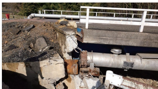
(b) 橋台後方部分の破損
