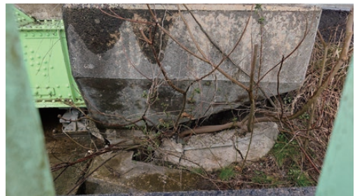
(g) 道路橋橋台の破損
