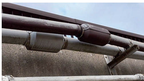
(c) 右岸伸縮可撓継手
