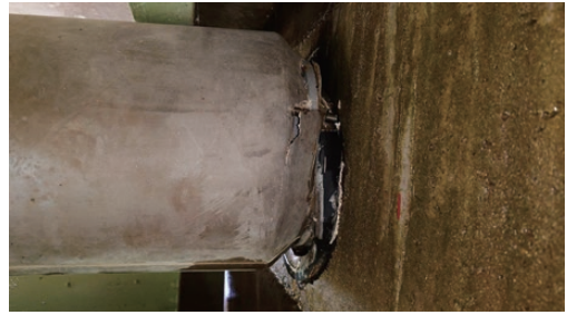
(e) 橋台に衝突した円筒摺動型継手
