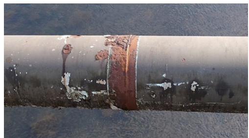
(c) 溶接部現地塗装範囲の腐食
