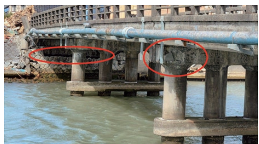
(d) 橋台、橋脚の損傷
