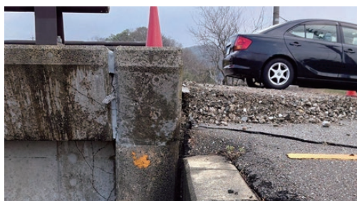
(c) 道路橋アプローチ部の段差
