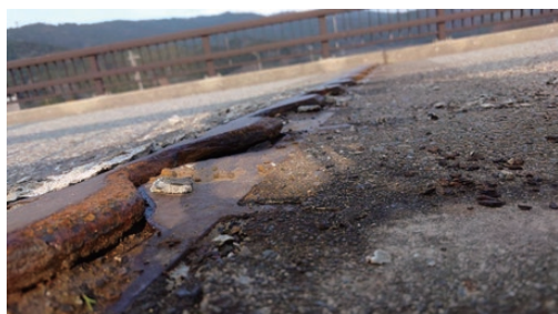
(d) 道路橋フィンガージョイントの損傷
