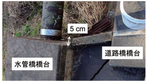
(b) 道路橋橋台に対する水管橋橋台のずれ
