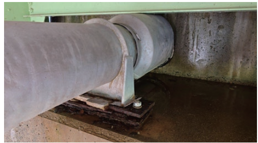
(f) 腐食した支承の破損
