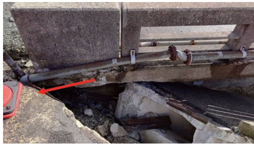
(b) 橋台背面沈下による添架管の変位
