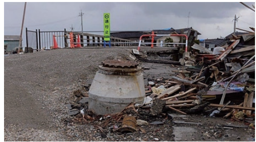
(b) 橋台背面地盤の沈下と突出したマンホール
