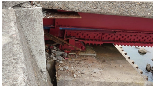
(b) 道路橋支承部破損
