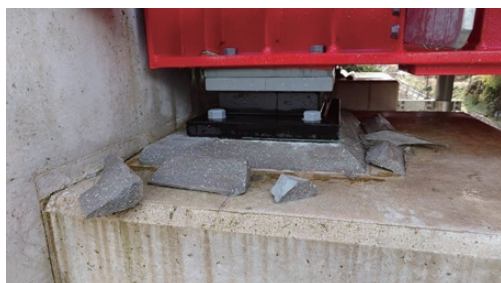
(b) 歩道橋柁座モルタル破損
