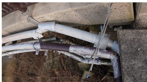
(b) 左岸側曲管部座屈
