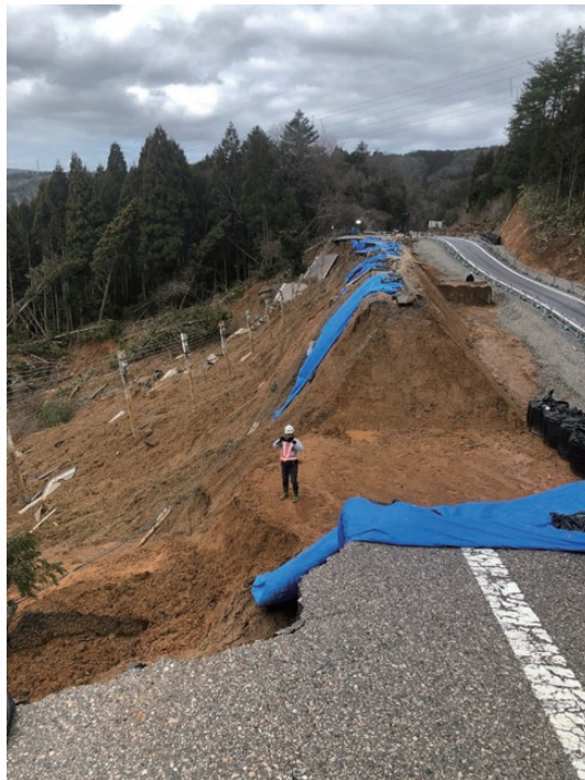
写真 のと里山海道における高盛土部の大規模崩壊 (右上部は緊急う回路) (筆者撮影)
