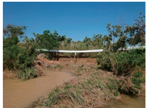
写真5 梅田川沿いの浸水により冠水・崩壊した道路周辺の様子
