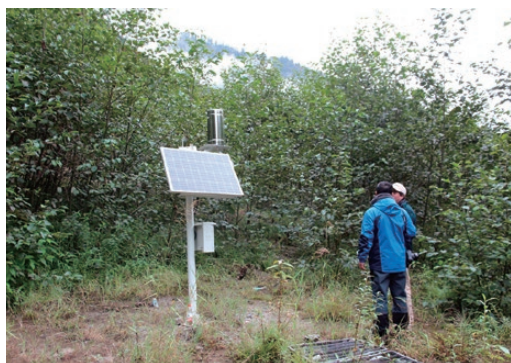
図4 チベットの危険地域に設置された傾斜センサー型斜面観測装置
