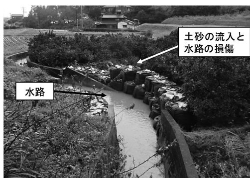
写真5 下流水路の損傷 (西分第2ため池)
