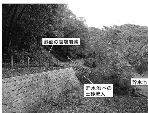
写真9 貯水池への土砂流入 (永祥庵ため池)
