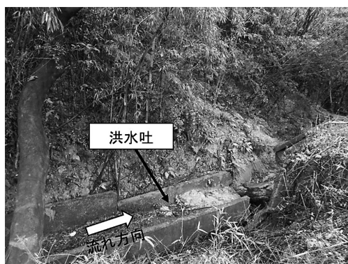
写真3 洪水吐の損壊（西分第1ため池）
