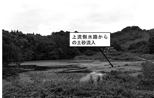
写真6 貯水池への土砂流入 (東分第1ため池)
