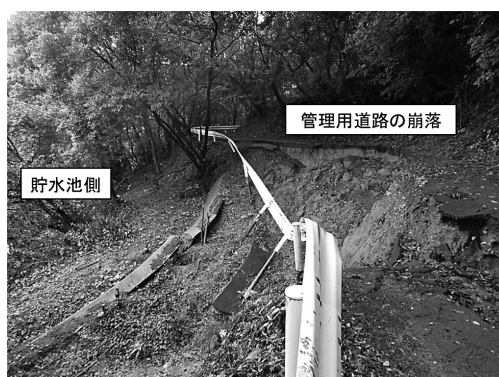
写真7 管理用道路の崩落 (池田ため池)
