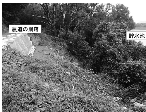
写真8 隣接農道の崩落 (北浦ため池)
