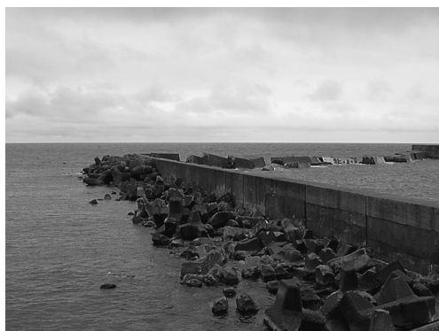
写真8-1 日本海の海岸構造物の破壊状況
