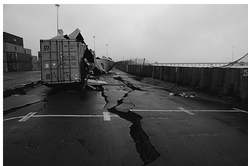
写真 6 コロネル港の自立矢板岸壁背面のコンテナヤードに発生したクラックの状況
