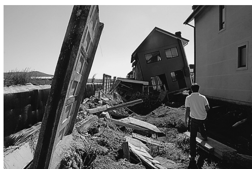
写真15 地盤の側方流動により傾斜した住宅 (ブリサ・デル・ソル)
