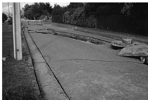
写真14 地盤変状によるアスファルト舗装の亀裂（アラウコ）
