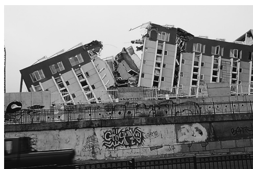
写真11 コンセプションの16階建てアパートの倒壊
