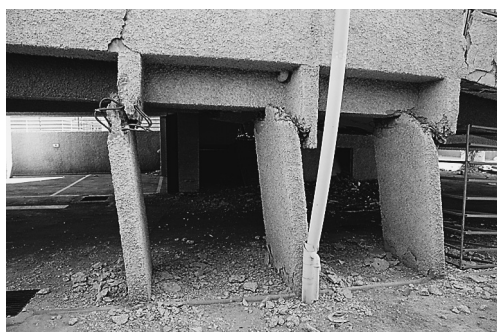
写真10 倒壊した壁式構造のアパートの壁のせん断破壊状況
