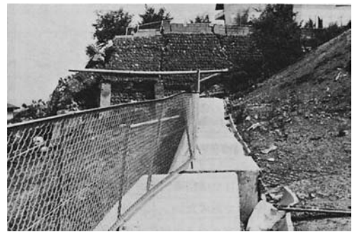
写真4 造成宅地の崩壊（仙台市緑ヶ丘）
