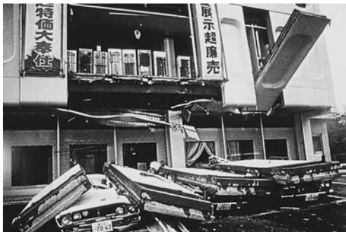
写真2 鉄骨造建物の外壁パネルの落下
